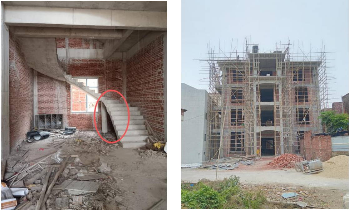
图 1、2 事故自建房安全防护建设情况
