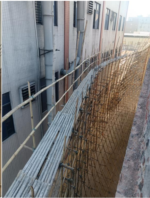
图 3 涉事脚手架脱离外墙情况
