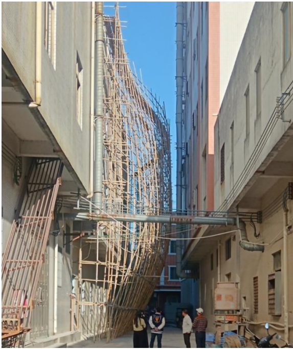
图 2 涉事脚手架倾斜情况
