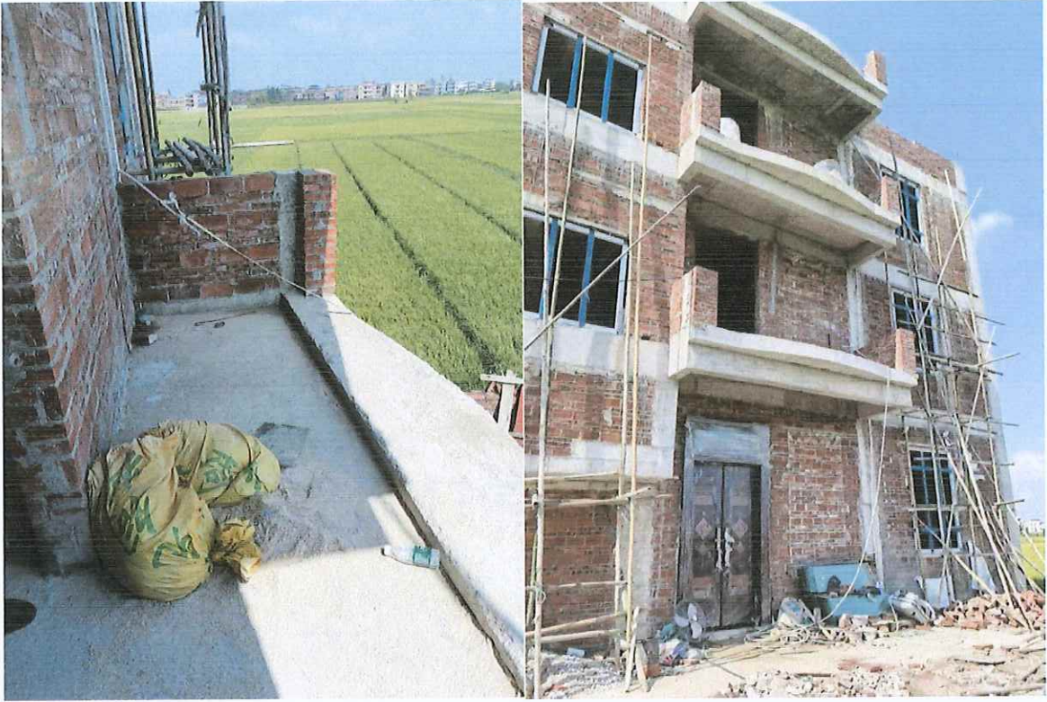
图 6、图 7 事故现场情况图
