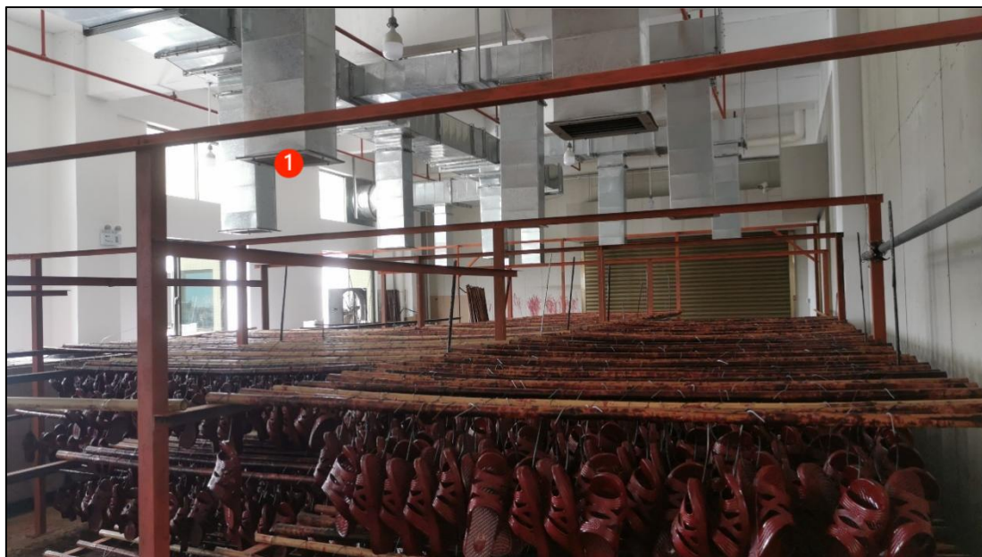
图 4-3 上色车间有机废气吸收口（①处为吸收口）
