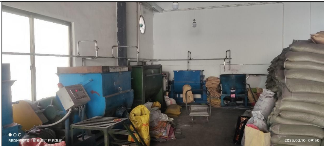
图 2-6 本项目搅拌机图片（上方管道为 DBP 管线）
